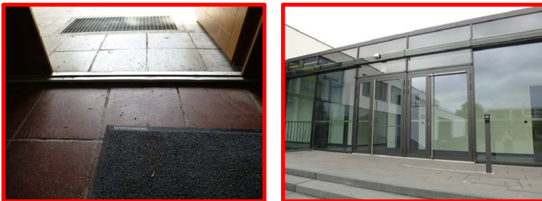
Abbildung 14: links - Türschwelle im Bestandsbau (Eingang 2) / rechts - unzureichende Markierung der Glasflächen (und Treppenstufenkanten)
