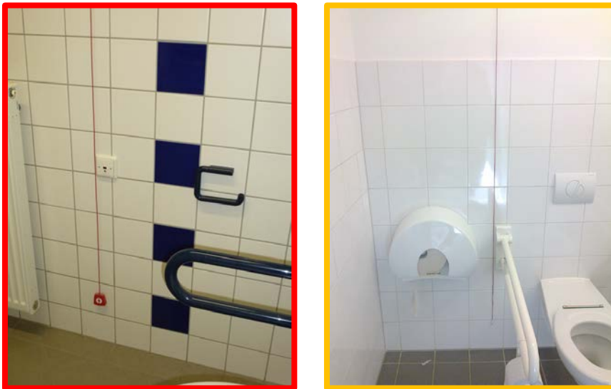
Abbildung 20: links - Notrufanlage nicht unmittelbar neben dem WC-Becken (Haus 2) / rechts - Notrufanlage unmittelbar neben dem WC-Becken (Schlüterstraße)
